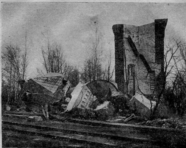
Разрушенная водокачка въ Къльмацахъ.
